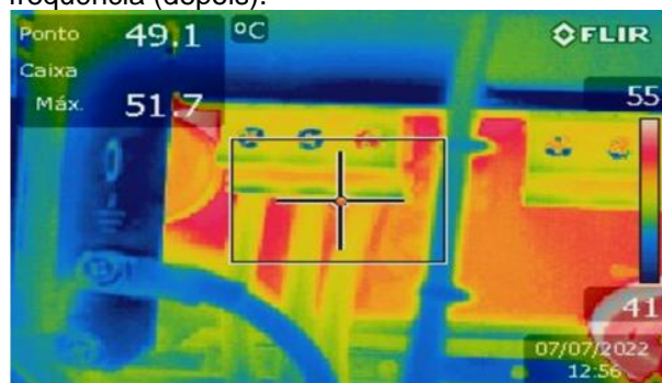
Figura 05: Imagem termográfica – Inversor de frequência (depois).
