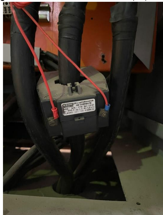
Figura 03: Transformador de Corrente (TC)
