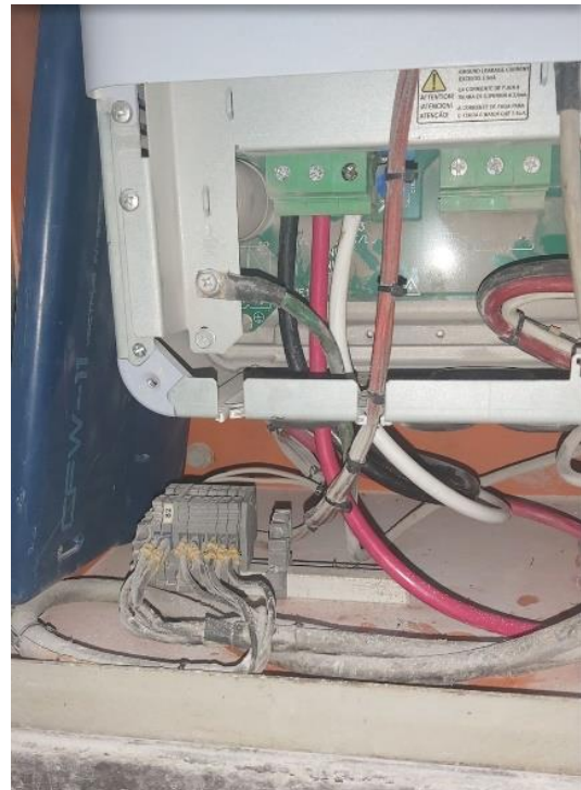
Figura 02: Inversor de frequência
