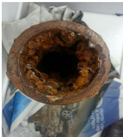
Figura 3.5 Incrustação depósito de cálcio em tubulações – redução do diâmetro
