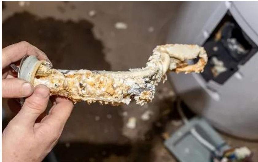
Figura 1.2 Tubulação com incrustação – excesso de cácio na água- www.blog.purific.com.br
