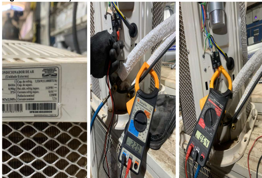
Figura 8 - Verificação da tensão e corrente elétrica
