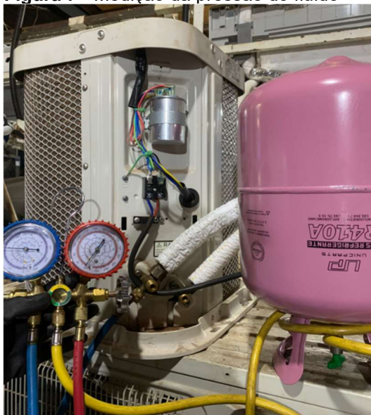
Figura 7 - Medição da pressão do fluido
