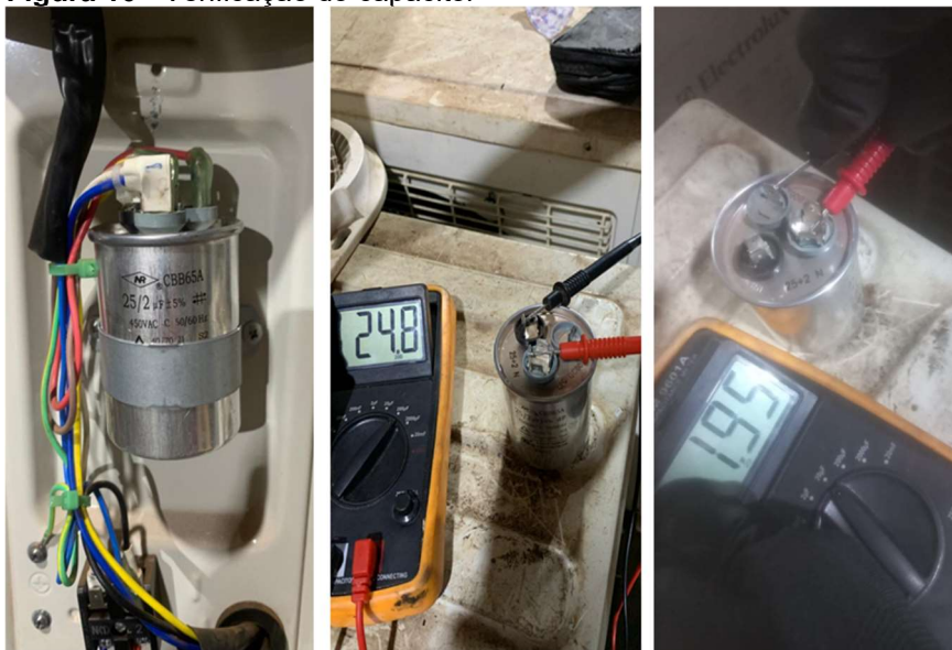
Figura 10 - Verificação do capacitor
