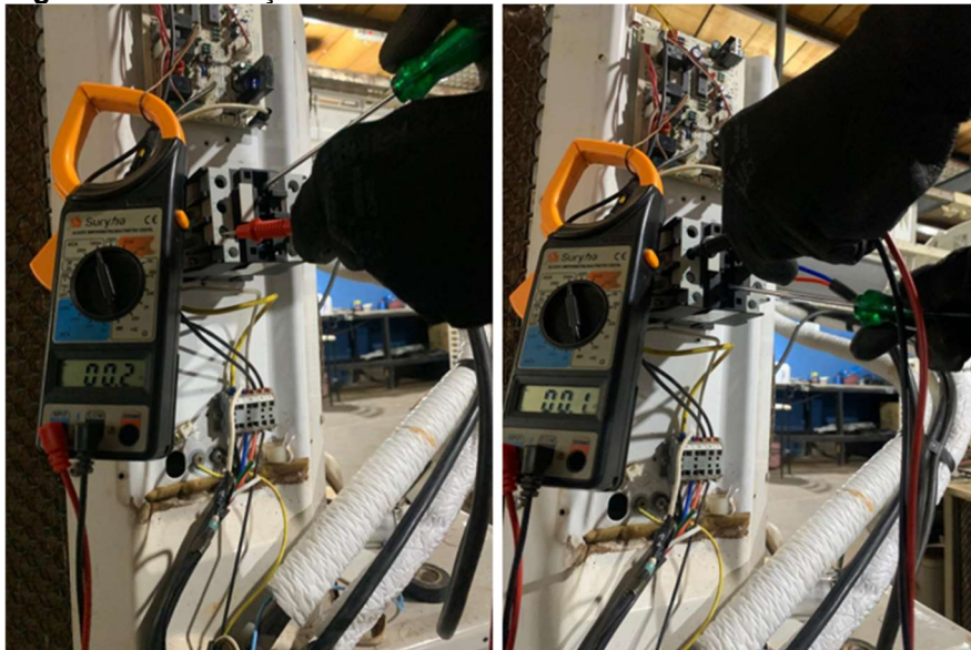
Figura 15 - Verificação de contator do condicionador de ar de 30.000 BTU/h
