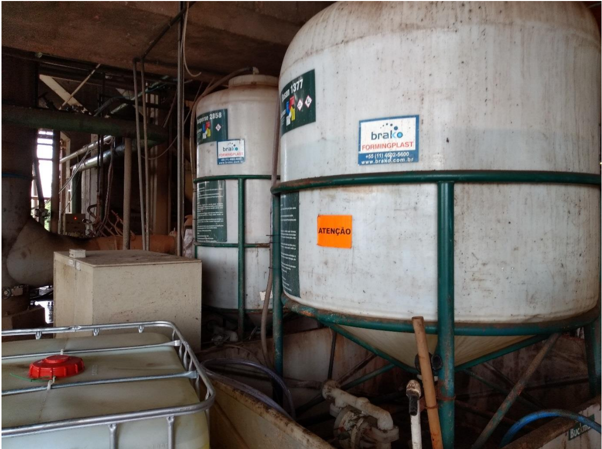
Figura 12: Tanque de químicos dos autores (2018).
