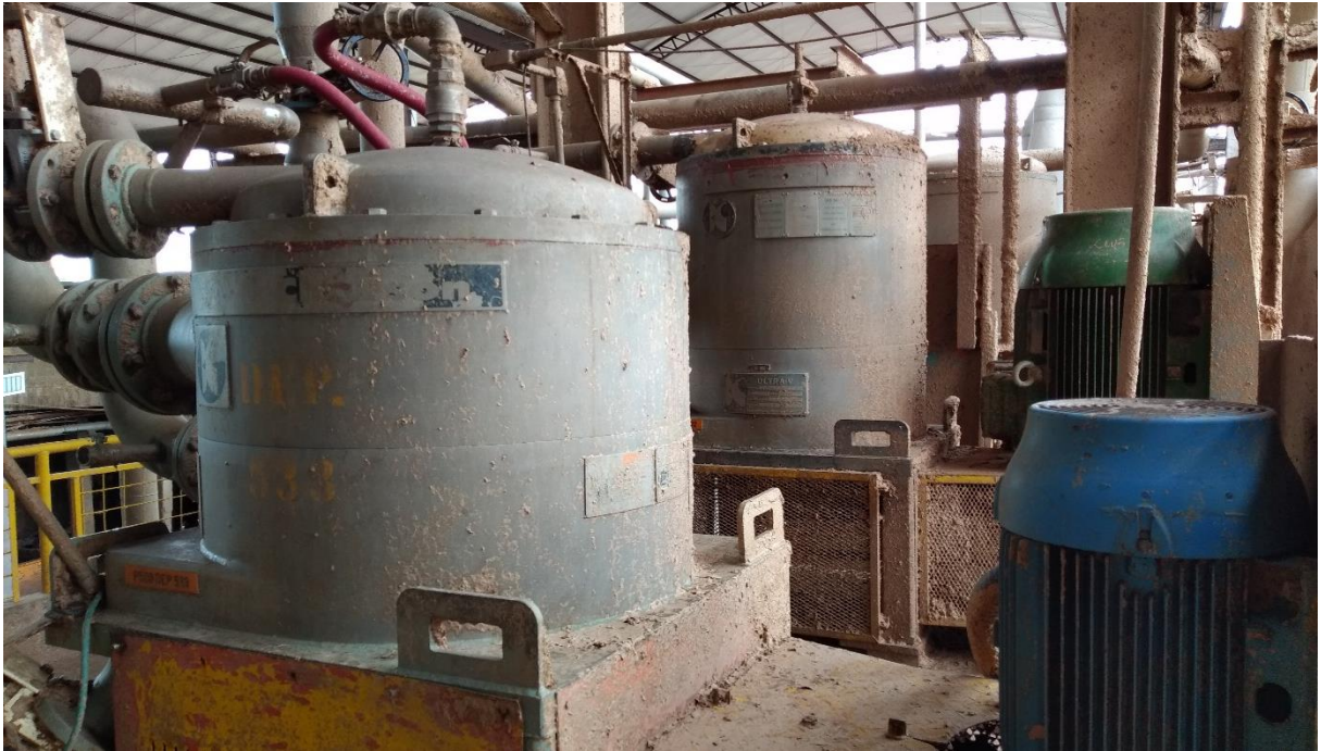
Figura 10: Depuradores dos autores (2018).
