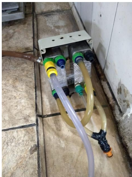
Figura 35: Trocadores de calor Fonte: Acervo do autor (2020)
