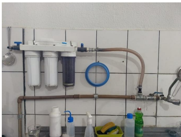
Figura 16: Conjunto de filtros Fonte: Acervo do autor (2020)
