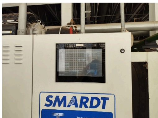
Figura 8: Painel do chiller.
