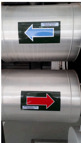
Figura 15: Tubulação do chiller.
