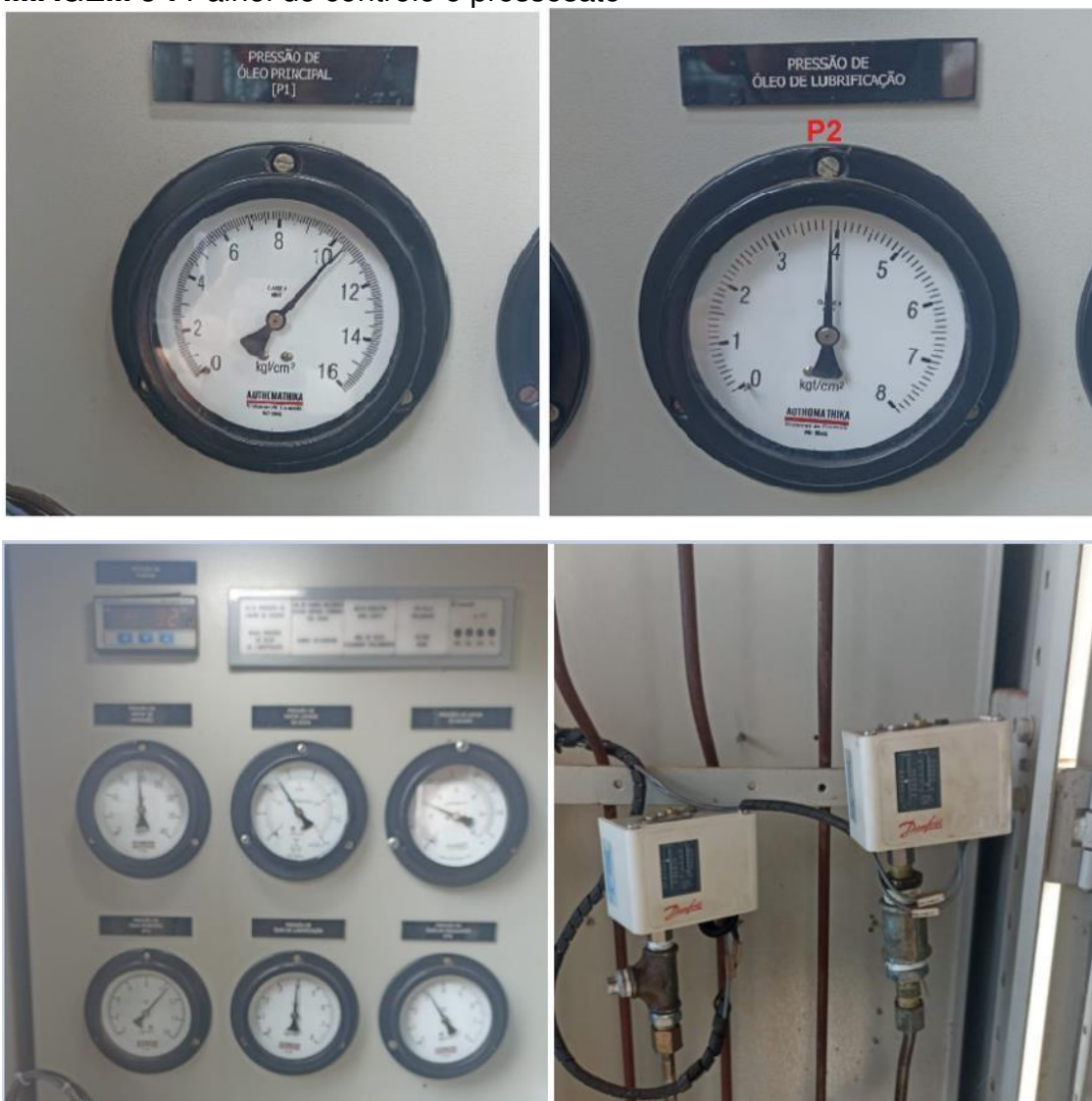
IMAGEM 5 : Painél de controle e pressosato
