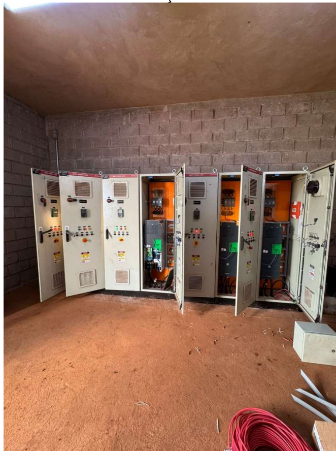
Painel De Instalação dos Inversores
