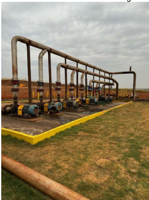
Sistema de Bombeamento de Água
