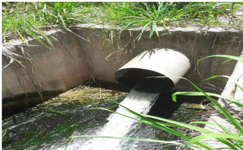
Figura 10 - Emissário do efluente industrial.
