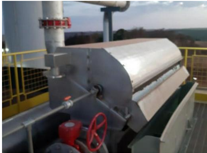
Figura 3 - Sistema de peneira rotativa utilizado no tratamento preliminar.
