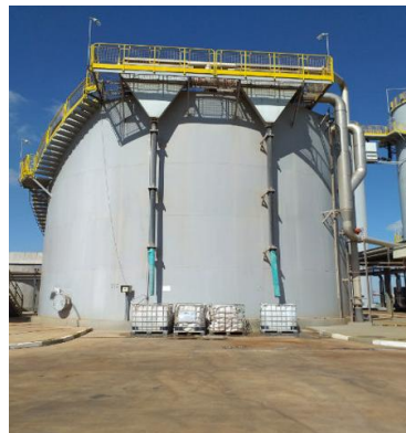
Figura 4 - Tanque de equalização do efluente industrial.
