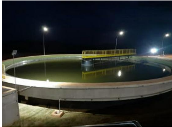
Figura 9 - Decantador secundário do efluente industrial.
