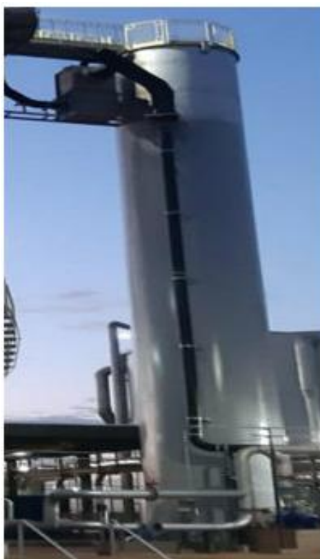
Figura 5 - Tanque de condicionamento do efluente industrial.
