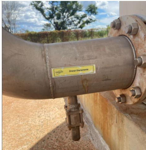
Figura 14 - Dreno na saída da tubulação do gasômetro.
