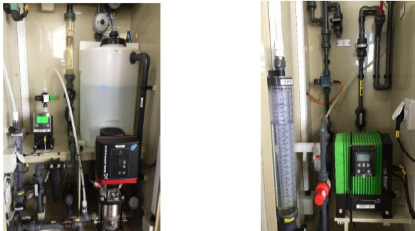
Figura 05 – Equipamento de preparo e aplicação da monocloramina
