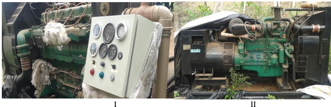
Figura 24 - Motogerador a Diesel convertido para Biogás / Motor Scania / 500 KVa Detalhe: I - Central de controle do motogerador / II - Vista geral do motogerador Fonte: ONDATEC - Tecnologia Industrial em Micro-ondas S.A.
