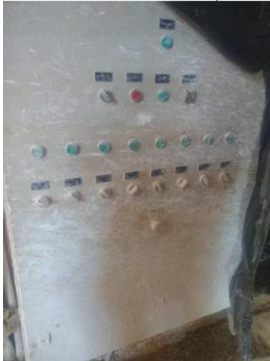
Figura 26 – Painel de acionamento de bombas – Preparo de leite de cal
