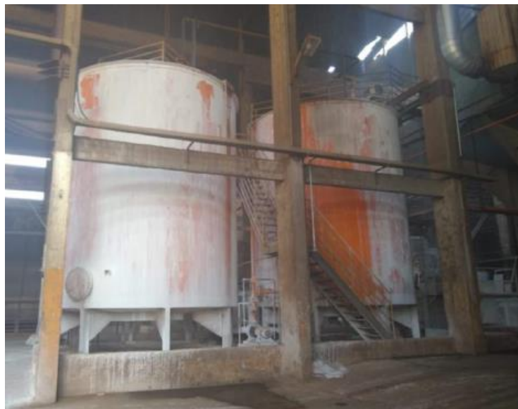
Figura 7 – Tanques de preparo de leite de cal
