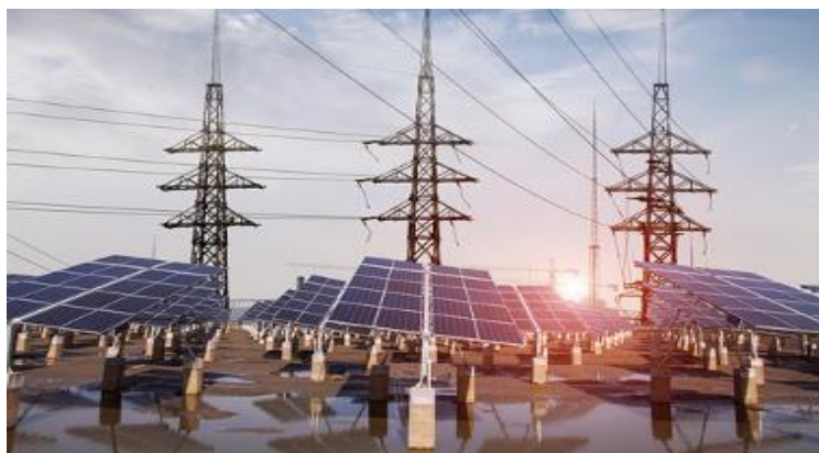
Figura 4 – Estação de captação de energia solar
